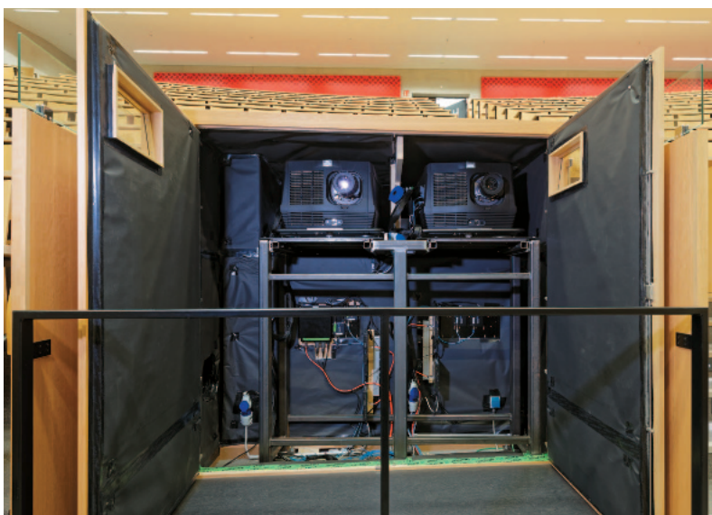
Eingehauste Projektoren im Gestühl eines großen Hörsaals
