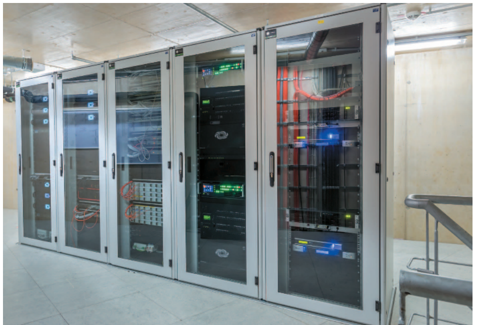
Eine der beiden Technikzentralen im C.A.R.L.
